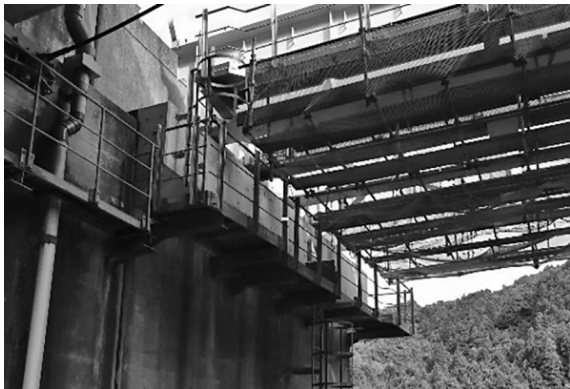
図-13 現地の設置状況
