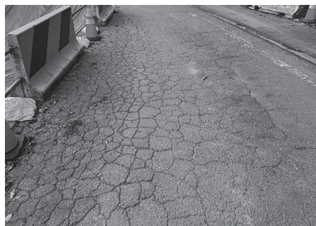
図-3 路面の状態
