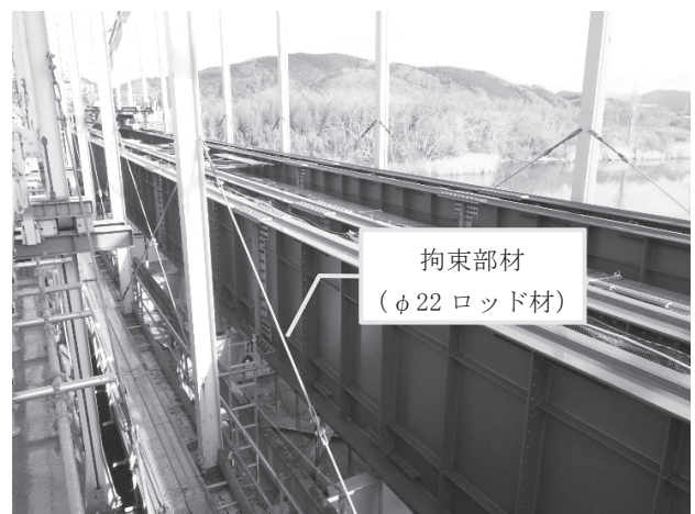
図-4 鉛直材拘束状況
