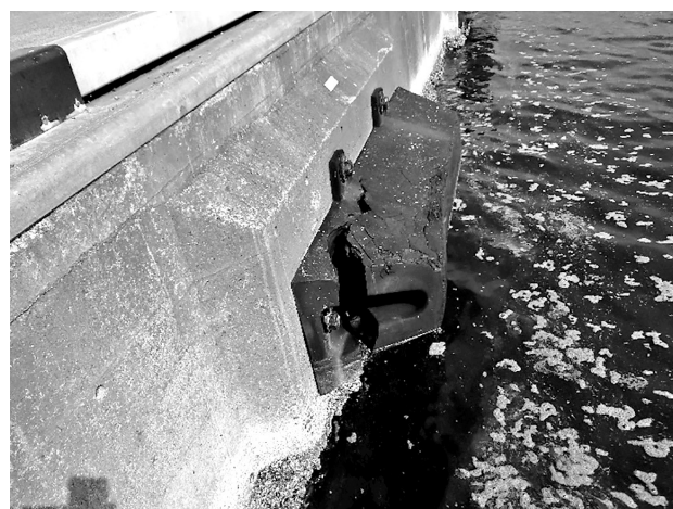
図-2 既設防舷材の劣化状況（撤去が必要）
