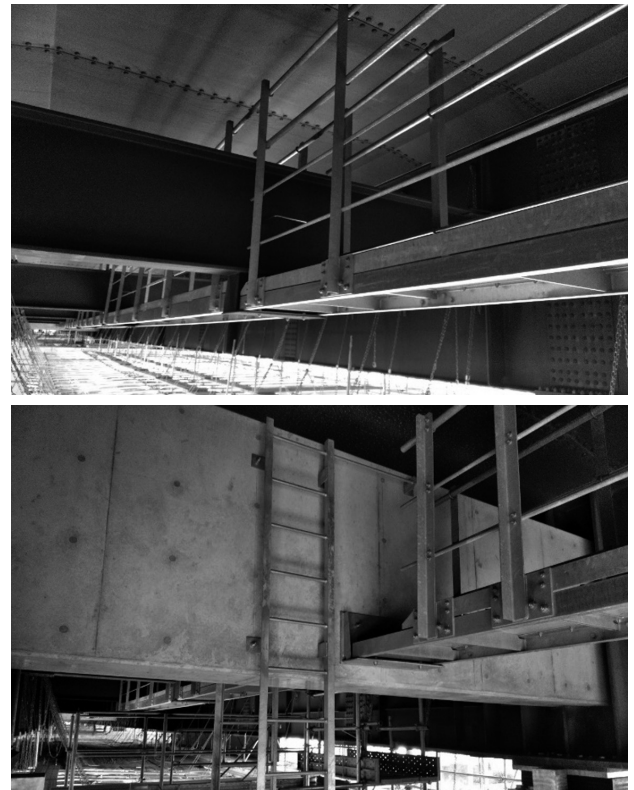
図-9 現地の設置状況
