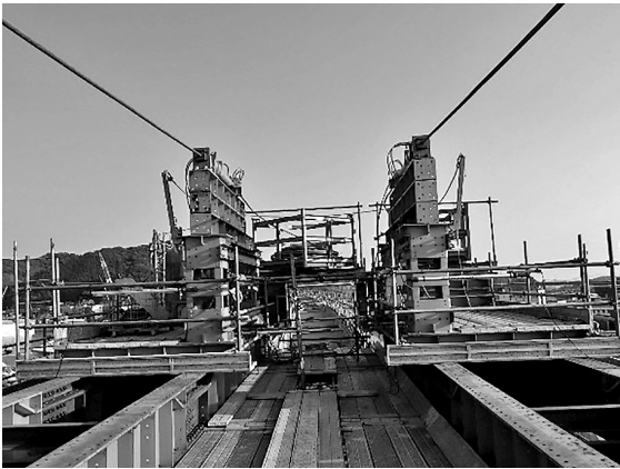
図-4 おしめ設備
