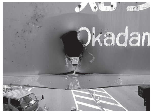
図-2 腹板損傷部
