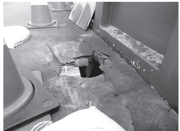
図-3 床版損傷部
