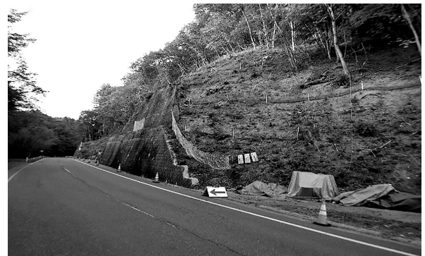
図-5 落石防護ネット、転落防止ネット
