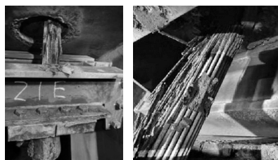
図-2 ケーブル腐食状況（下弦材内部）
