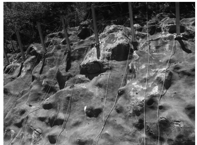
図-5 位ヶ原2工区 既設吹付法面 補修前
