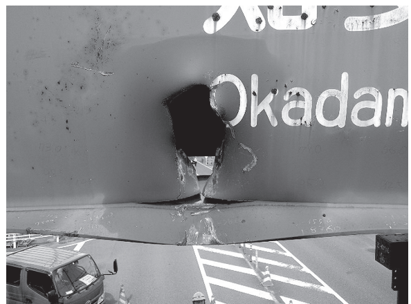
図-2 腹板損傷部
