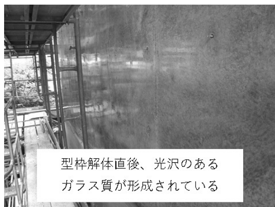
図-5 脱型直後のコンクリート表面
