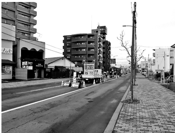
図-2 作業帯工事防護柵
