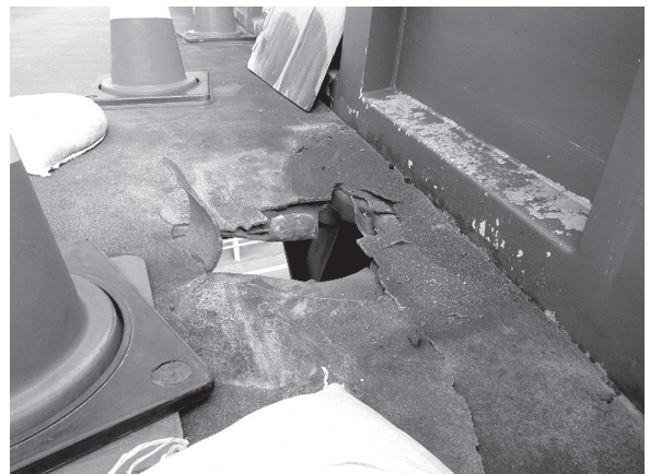
図-3 床版損傷部
