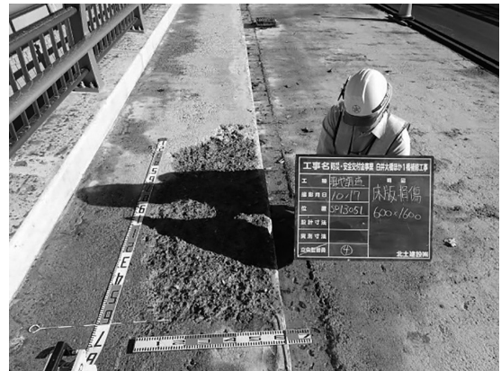
図-3 床版劣化事例
