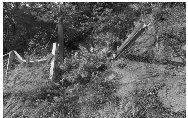
図-1 位ヶ原2号工区 ロックネット工損傷
