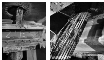
図-2 ケーブル腐食状況（下弦材内部）
