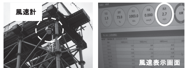
図-5 風速計設置状況 図-6 風速監視画面
