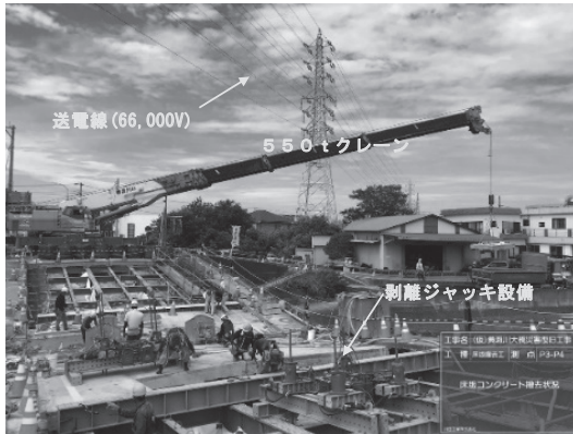
図-7 床版剥離・撤去状況
