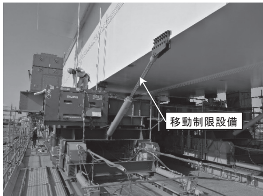
図-7 台車部橋軸方向移動制限設備
