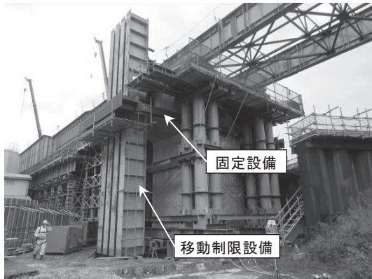
図-6 橋脚部直角方向移動制限設備
