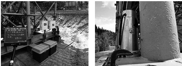
図-2 設置全景と『チルトウォッチャー』
