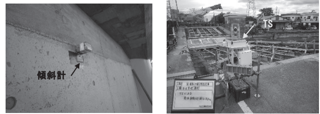
図-8 傾斜計 (P4) とTS自動追尾システム
