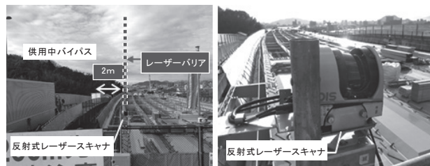
図-7 反射式レーザースキャナ設置状況
