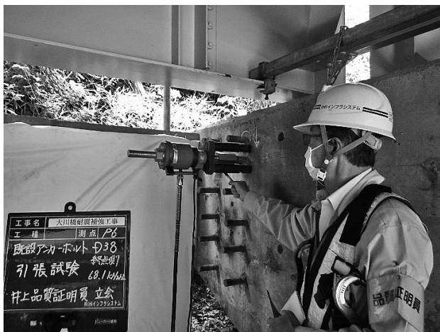
図-2 既設アンカーボルト引張試験
