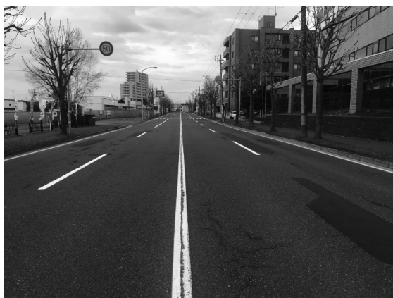
図-1 該当道路着手前損傷状況
