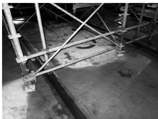
図-3 移動式支保工における車輪・レール
