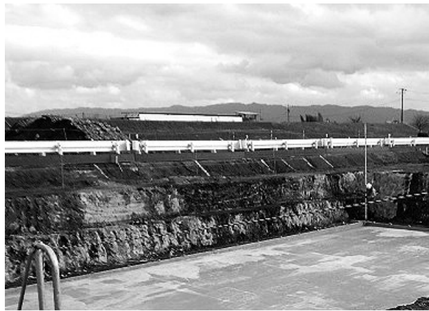
図-2 迂回路と床掘との落差状況
