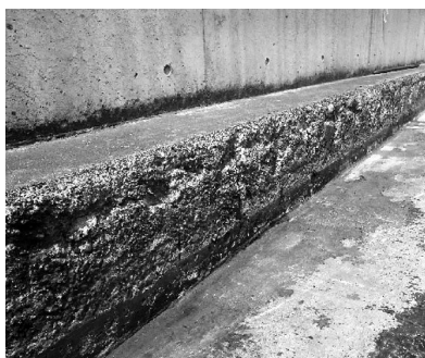
図-2 塩カルによるコンクリートの剥離及び鉄筋腐食状況
