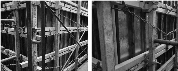
図-7 サーモフィッター設置状況 (P7底版) (左：設置無し、右：設置有り)
