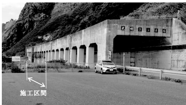
図-1 新武好覆道（左奥、武好トンネルとの接続ブロックが今回補修対象部分）
