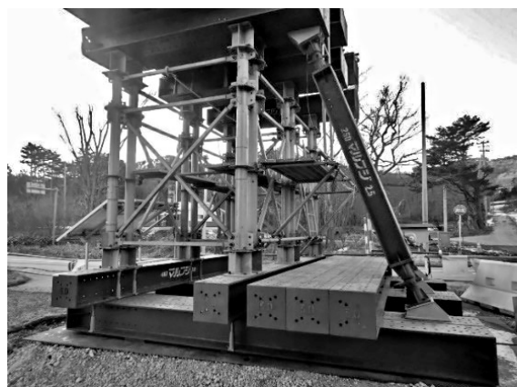
図-5 ベント設備転倒防止設備
