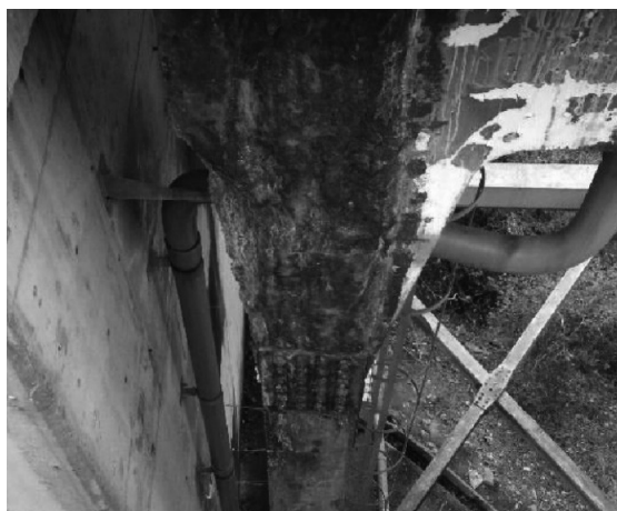
図-1 鉛直材の腐食損傷状態
