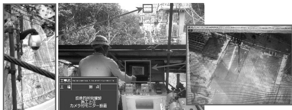
図-6 カメラ付きモニター設置
