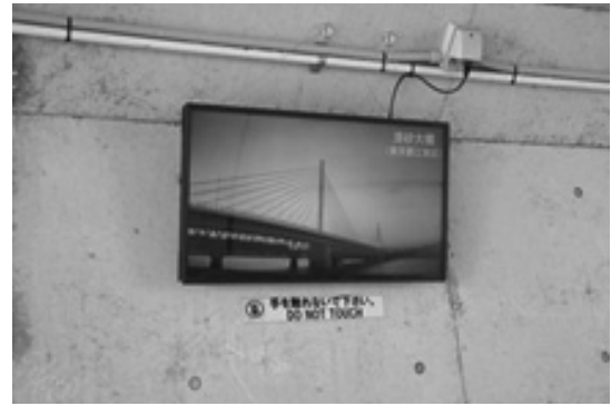
図-2 駅前地下通路に設置した液晶モニタ(6台)
