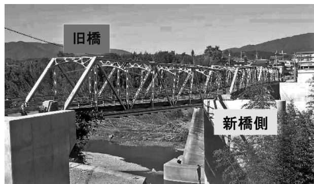
図-2 旧恋野橋崩落状況
