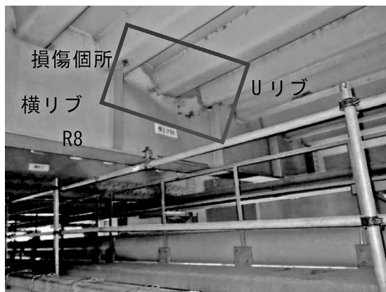
図-1 鋼床版、横リブ損傷状況
