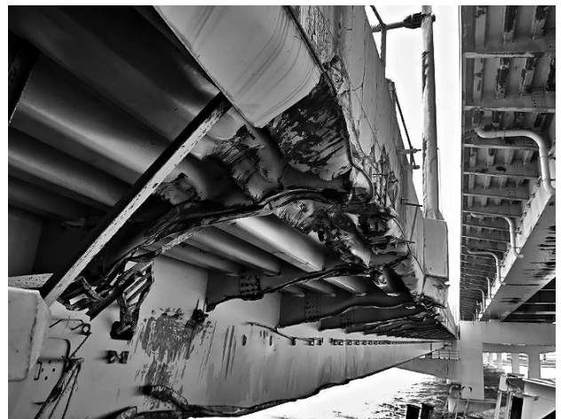
図-2 主桁、鋼床版損傷状況
