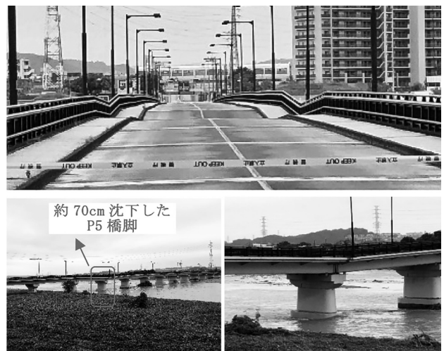
図-1 被災時状況
