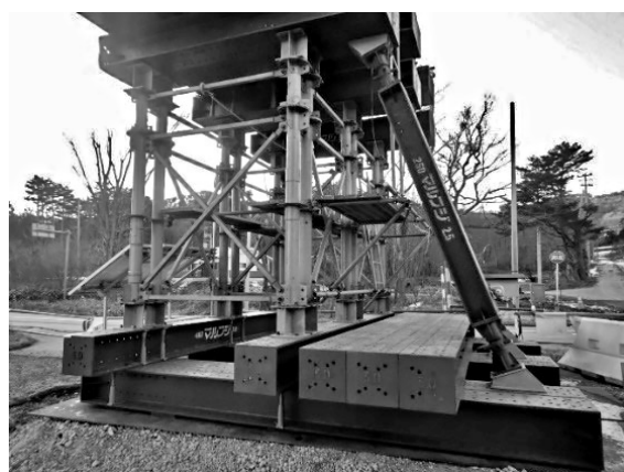
図-5 ベント設備転倒防止設備
