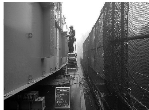
図-10 桁上覆工落下防止柵
