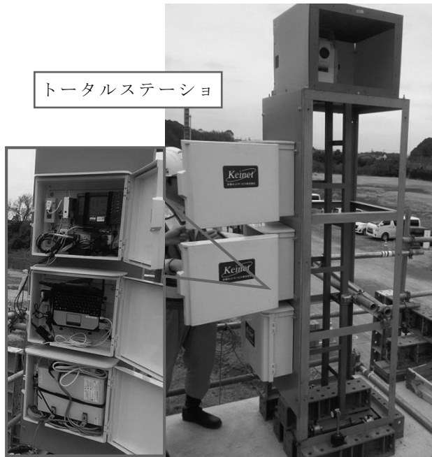
図-3 橋梁桁変位自動計測システム
