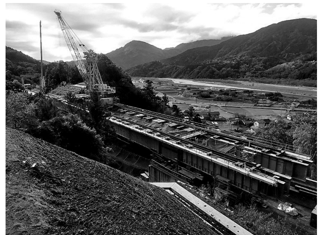
図-8 TRC軌条設備
