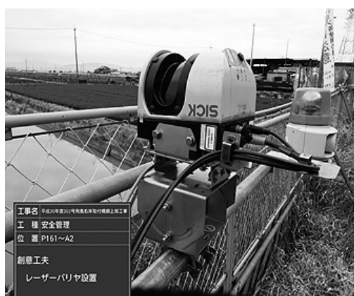
図-3 レーザーバリア警報監視システム
