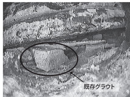
図-2 既存グラウトによる狭窄部
