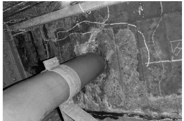
図-1 排水桷部漏水による損傷事例
