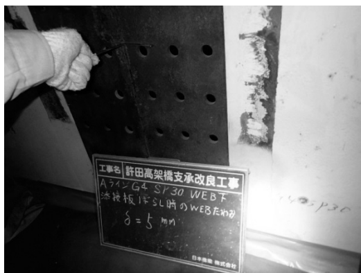
図-7 連結板取り外し時のたわみ量
