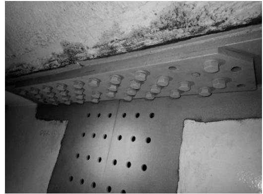
図-8 ボルト抜け落ち写真
