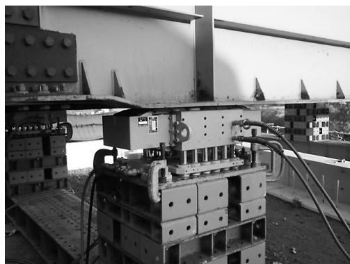
図-4 シンクロジャッキ設備
