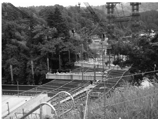
図-2 無負荷状態での主桁受け梁
