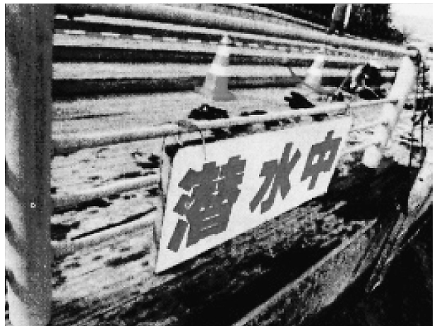
図-1 潜水作業中明示看板
