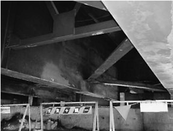
写真-1 火災した本橋の損傷状況
