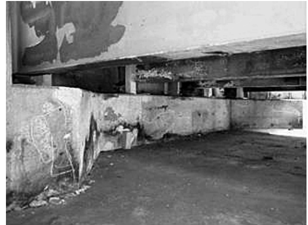
写真-4 橋脚コンクリートの損傷状況
