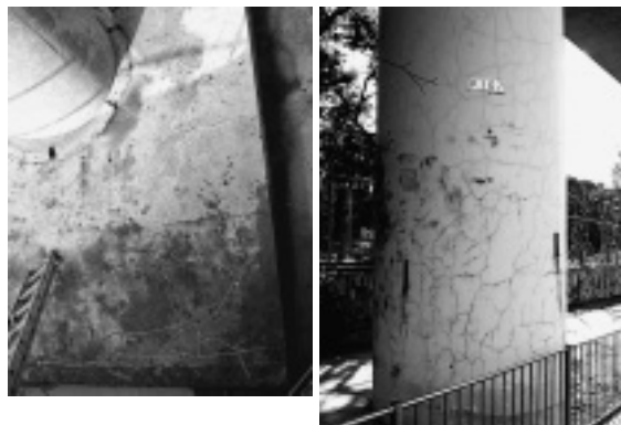
柱 フーチング 写真-2 ひび割れ発生状況
