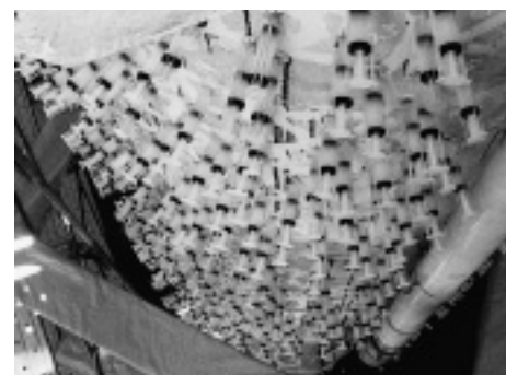
写真-8 柱部へのひび割れ状況 2
