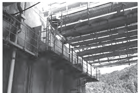
図-13 現地の設置状況
