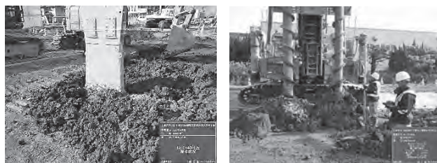
図－1 盛上り土発生状況 （左：SCM工法、右：RMP-MST工法）
