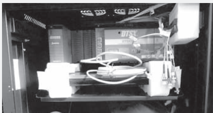
データロガー保管箱内部
