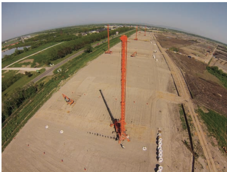
パーチカルドレーン工の施工全景です。2工区で6機が並行作業しています。
