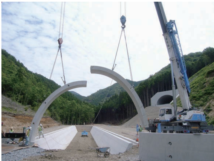
高速道路下、アーチカルバート工の施工現場です。 さあ、組立開始・・・の雰囲気伝われば。(撮影地・九州、撮影時間帯・午前)
