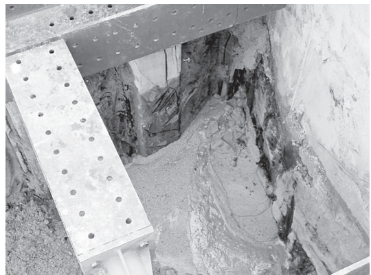
写真-1 出水状況
