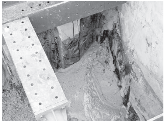
写真-1 出水状況
