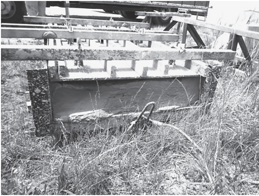
写真-9 壁面B型枠転倒直後
