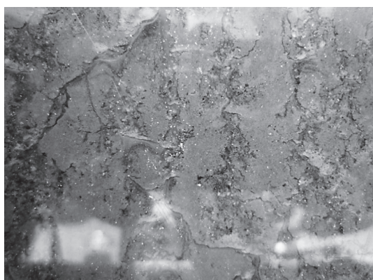
写真-5 骨材の沈下、水分の上昇
