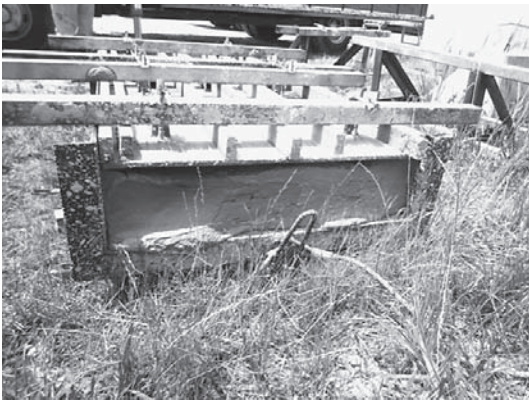
写真-9 壁面B型枠転倒直後
