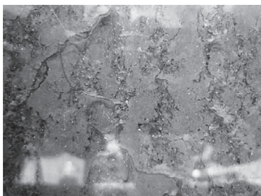
写真-5 骨材の沈下、水分の上昇
