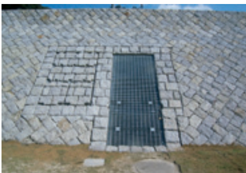
図－４ 樋管機械室の格納状況
