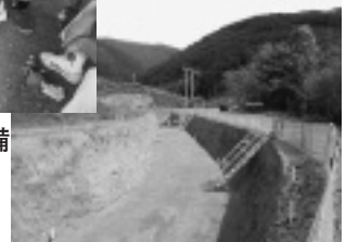
写真-11 転落防止ネット・昇降設備
