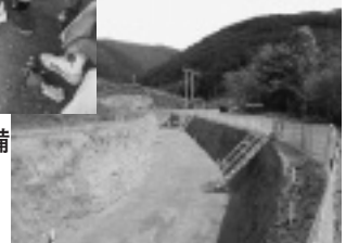
写真-11 転落防止ネット・昇降設備
