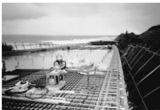
写真-1 雪寒仮囲災害状況
