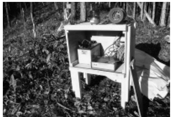
写真-4 地すべり警報装置
