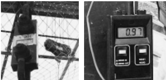
写真-10 テンションメーター及び遠隔モニター
