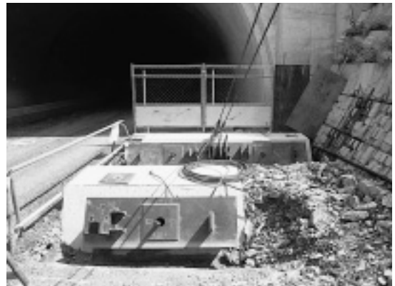
写真-4 A1ケーブルクレーンアンカー
