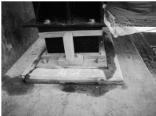
写真-1 沓モルタルのひび割れ状況
