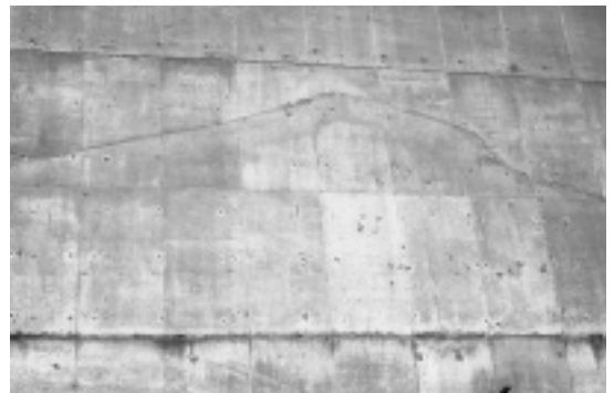
図1 コールドジョイントの事例
