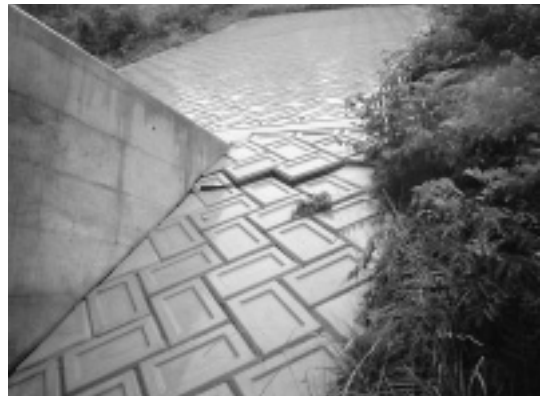
写真-1 張ブロック沈下後
