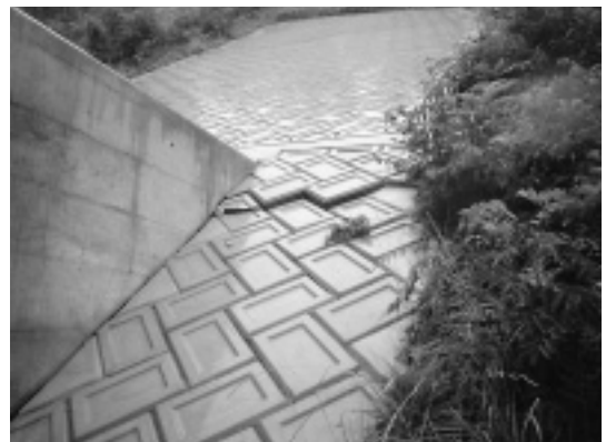
写真-1 張ブロック沈下後
